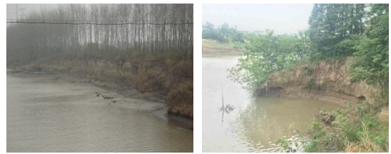
图 1 新孟河河道崩岸情形
