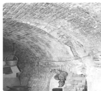
图3 地裂缝活动引起地下砖衬洞室剪断破坏
