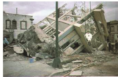
(b) 建筑物破坏情况
