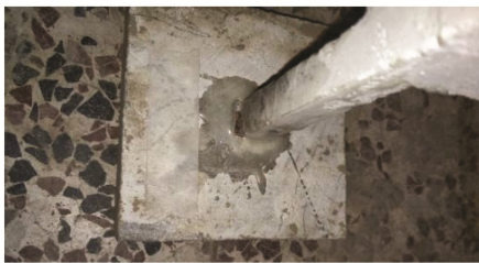
(a) 常规框架结构柱底破坏
