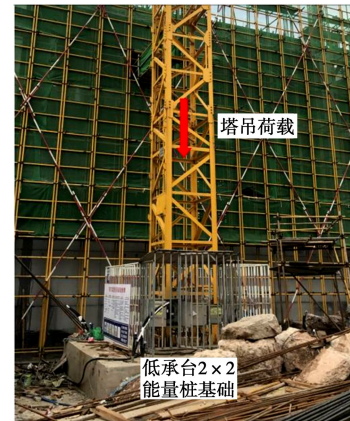
(a) 塔吊实物图
